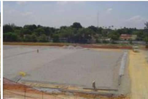
Foto 06 - Conclusão do colchão drenante. Podemos distinguir os tubos de PVC nas extremidades.
