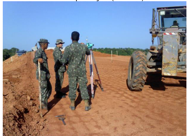
Verificação da Eq Topo (Foto 06)
