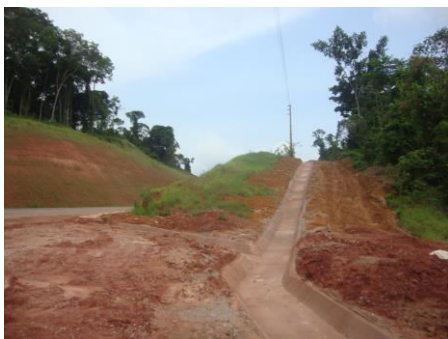
Dispositivo de drenagem (VPC)
